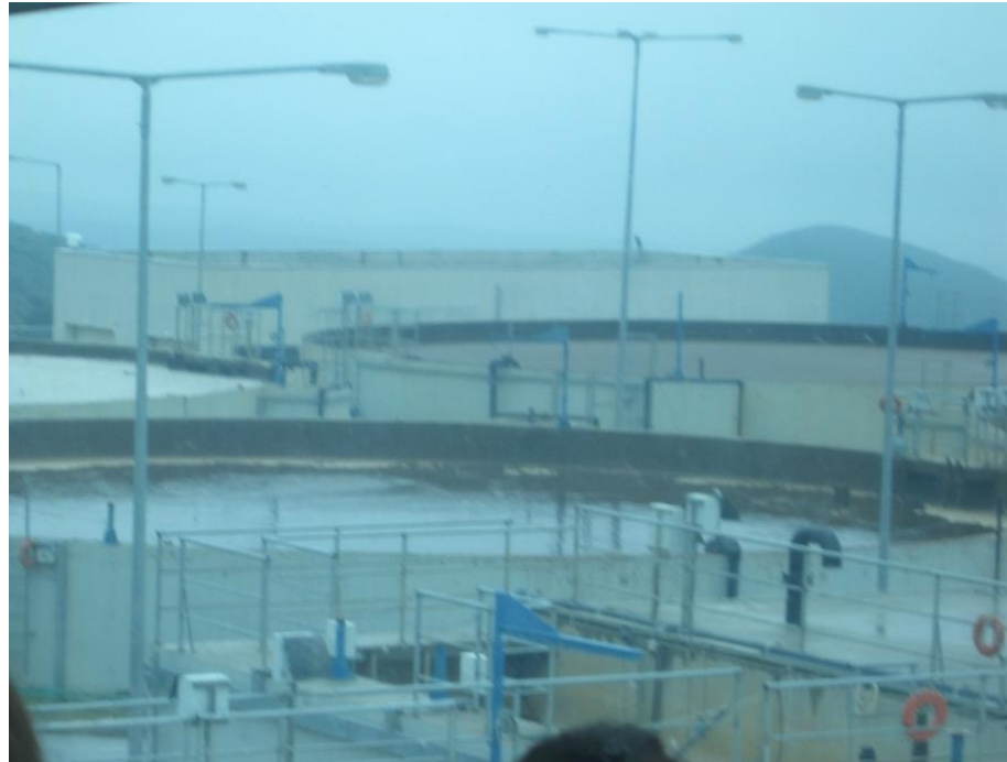
Εικ. 5.11. Μονάδα επεξεργασία στραγγισμάτων στο ΧΥΤΑ Μαυροράχης Θεσσαλονίκης.
