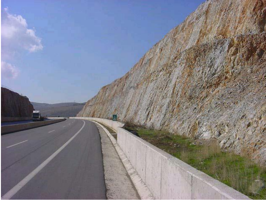
Σχήμα 9: Παράδειγμα πρηνούς σε όρυγμα σε αυτοκινητόδρομο – Εγνατία Οδός Α.Ε.
