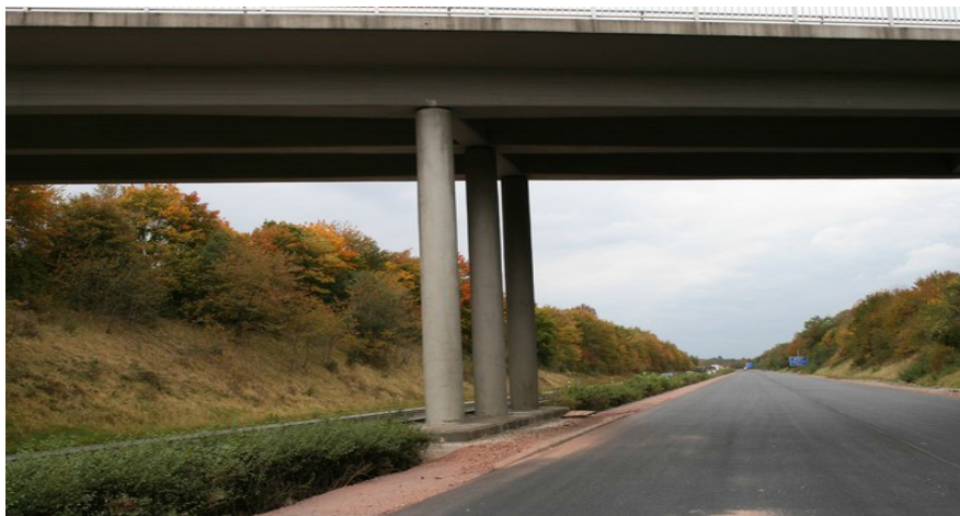
Βάθρα που δεν έχουν υπολογισθεί έναντι πρόσκρουσης οχημάτων – Κίνδυνος κατάρρευσης φερόντων στοιχείων → Κατηγορία κινδύνου 1
