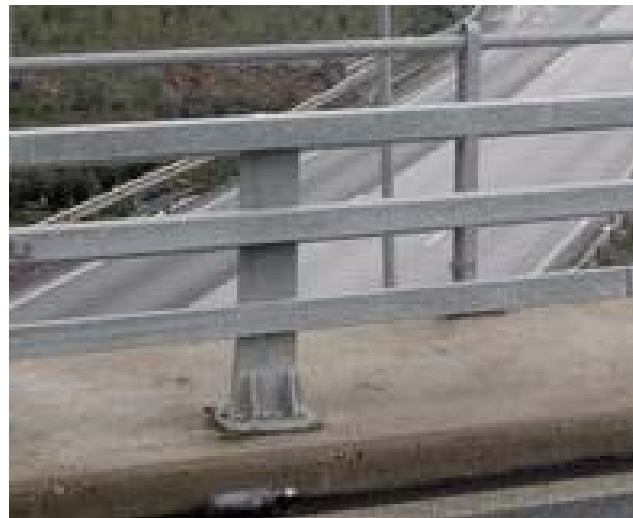
Εικόνα 1: Παράδειγμα μεταλλικού στηθαίου γέφυρας
