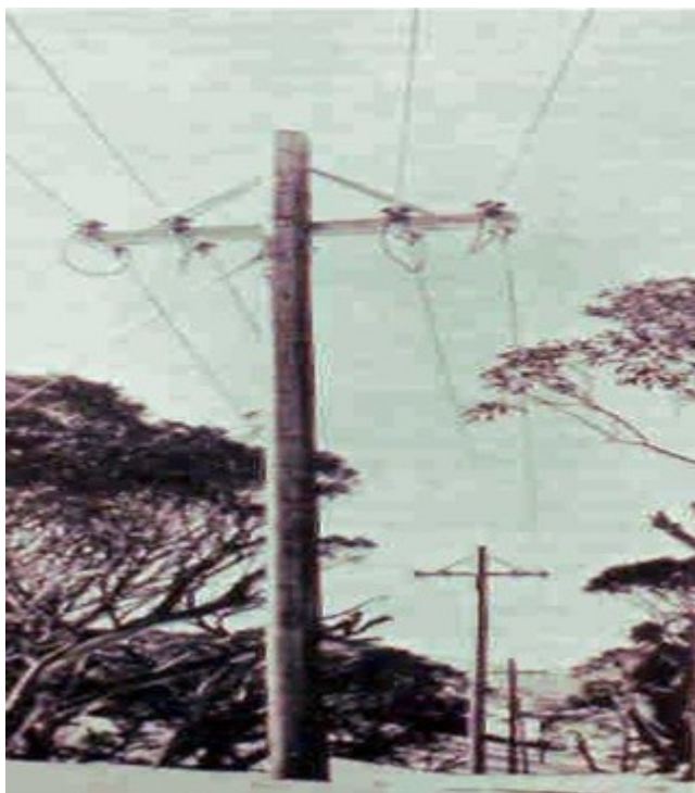
Εικόνα 7.9. Εμποτισμένοι στύλοι ΔΕΗ
