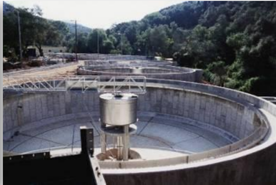
Εσωτερικό δεξαμενής – Κώνος συγκέντρωσης ιλύος – Ξέστρα πυθμένα
