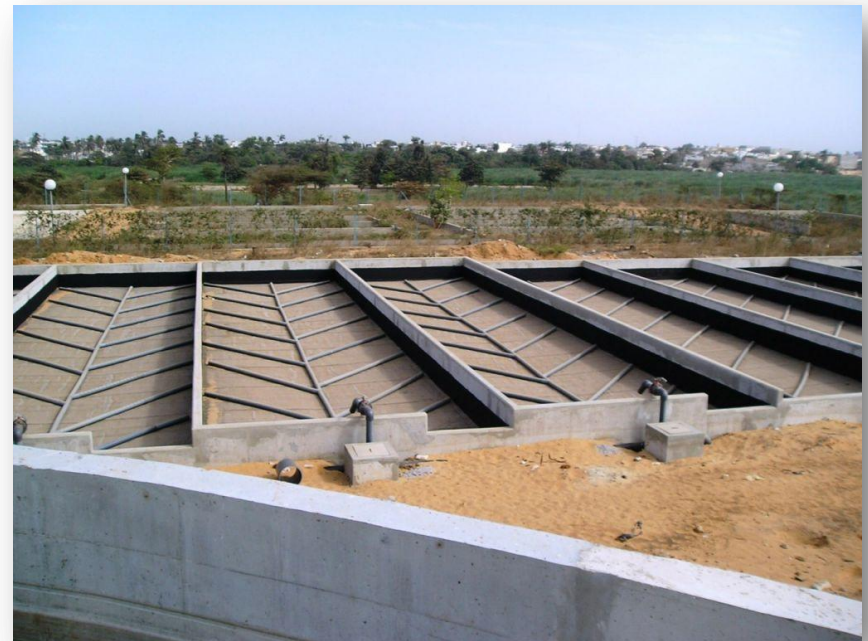
Σύστημα drainage σε κλίνες ξήρανσης
